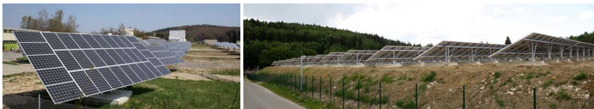
Abb. 12: Zwei der großen Photovoltaik-Anlagen in Engstingen (beide Gewerbepark Haid)
